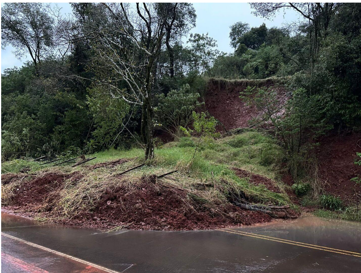
Deslizamento também atingiu rodovia na entrada de Modelo (Foto: NSC TV/Reprodução)
