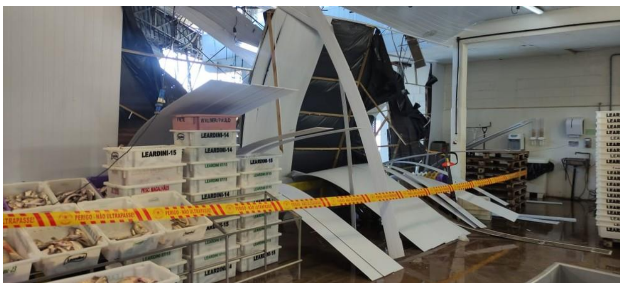
Queda de parede em SC — Foto: Corpo de Bombeiros/Divulgação
