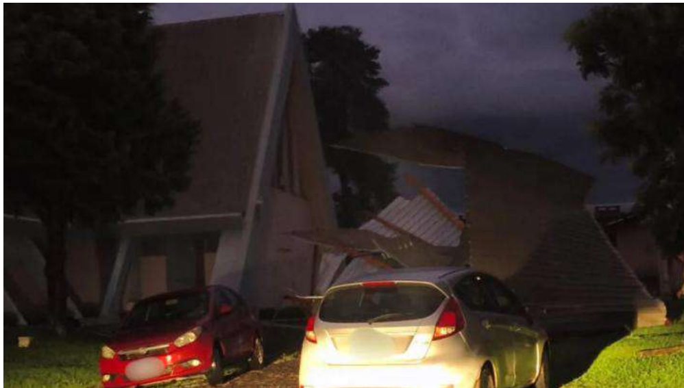
Vendaval atinge Ponte Alta do Norte e causa destelhamentos em moradias e comércios | Foto: Prefeitura de Ponte Alta do Norte
